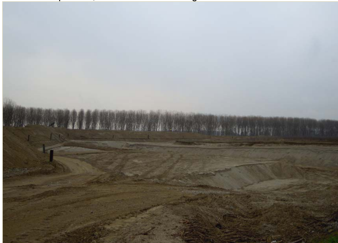
FOTO 3: Comparti 2B, 3B e 4B: stato dei luoghi ad attività estrattiva avviata
